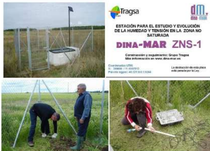
Figuras 9-17 a) a d). Momentos de la instalación de los sensores, aspecto final y placa identificativa de la estación DINA-MAR ZNS 1 en Santiuste de San Juan Bautista (Santusi). Foto: 26/05/2008.
