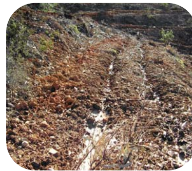
La realización de surcos o zanjas de contorno reducen la erosión hídrica y aumentan el tiempo de permanencia del agua en la ladera, favoreciendo la infiltración natural, la recarga de los acuíferos y el desarrollo de la plantación. (Foto TRAGSATEC).
