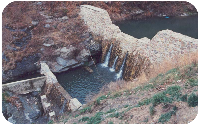
Dique en un torrente de Sierra Nevada (Granada). Lamina el caudal punta y aumenta la infiltración (Foto TRAGSATEC).
